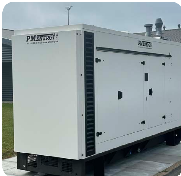
Nødgenerator på Knivholtvej
