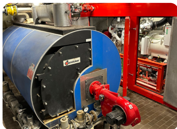
Gasmotor og -kedel på Frederikshavn Renseanlæg
